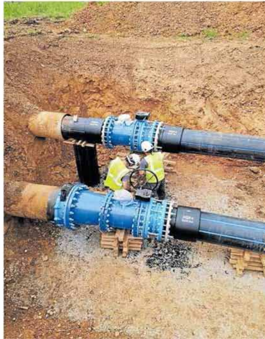
Válvulas de cierre del paso del agua en Fano.
